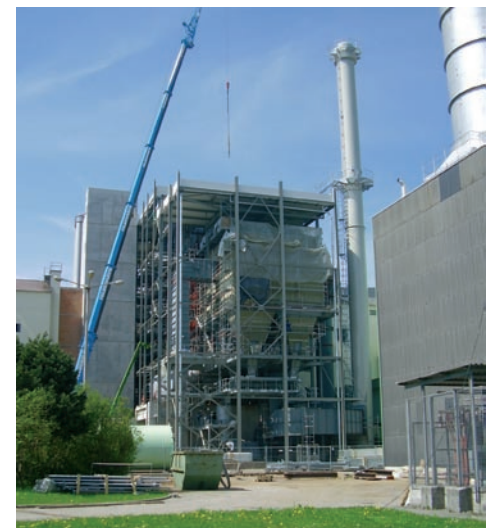
Rauchgasreinigungsanlage Biomasse-Heizkraftwerk Timelkam.
